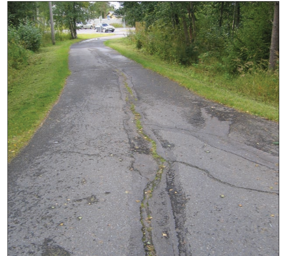
Kuva 11. Halkeillut kevyen liikenteen väylän päällyste Kuivasjärvenellä.
